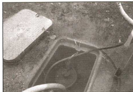
Überfluteter Ventilkasten gefährdet die elektrische Funktion der Ventile
