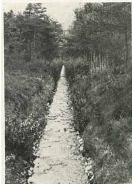
Abb. 4: Steinschale mit Fugenbepflanzung. Im Bereich des ständigen Wasserflusses sind die Kalksteine sichtbar
